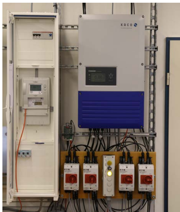
Abbildung 8: Testfeld 1 zeigt den Aufbau für den Test von SunSpec und dem proprietären Kaco Protokoll. Der Wechselrichter befindet sich rechts in der Mitte vom Bild. Darunter ist die Umschaltungseinheit für den Betrieb an einer Ost-West-PV-Anlage oder zweier Netzteile für den sonnenstandsunabhängigen Betrieb. Im Bild links befindet sich ein Easy Meter Zähler mit aufgesteckter Conexa Kommunikationseinheit.
