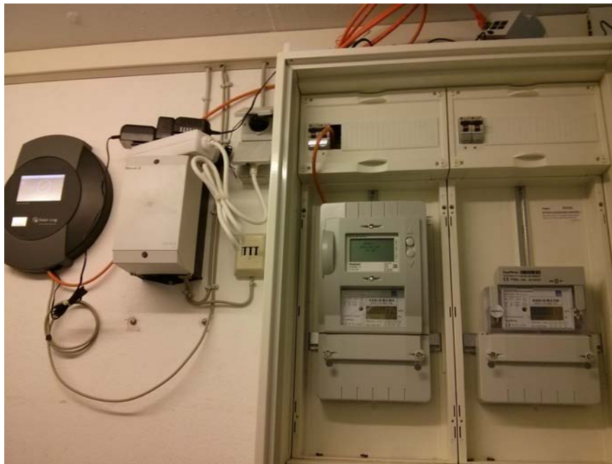
Abbildung 13: Installation im Kindergarten Lettenwald. Links im Bild ist der SolarLog. Die Conexa und ein wireless M-Bus Aufsteckmodul sind auf den Zählern im Zählerschrank installiert. Der Raspberry Pi ist auf dem Zählerschrank angebracht
