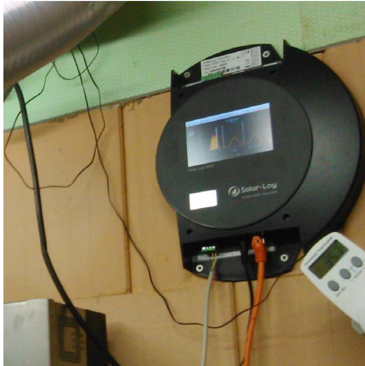
Abbildung 14: SolarLog 1200 installiert im Projekthaus Ulm
