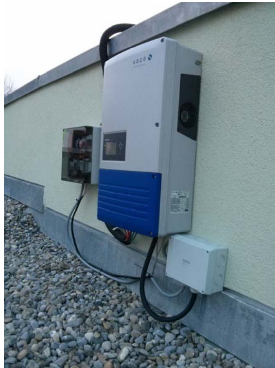
Abbildung 12: Installationen am Kindergarten Sonnenschein in Beimerstetten. Installiert wurden die beiden Boxen links und rechts vom Wechselrichter
